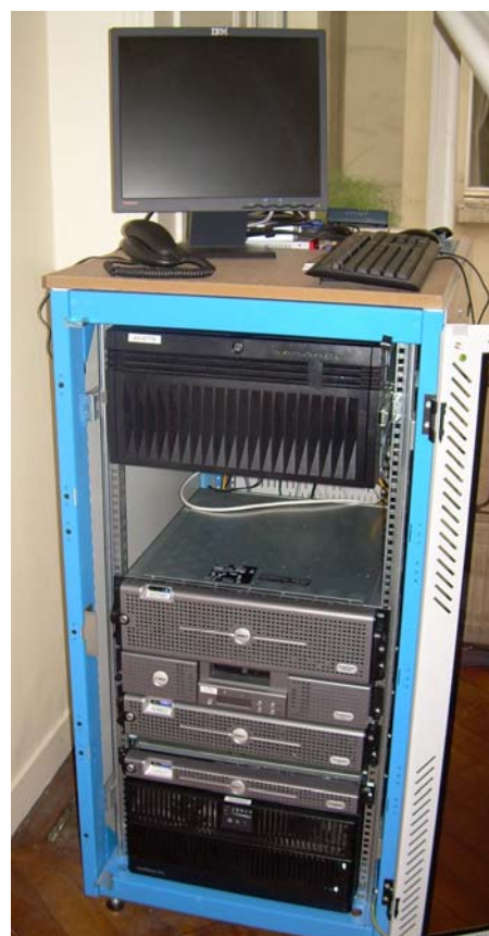
La baie informatique de Bruitparif comprenant un serveur bureautique, une baie de disques durs, un gestionnaire de sauvegardes, un serveur destiné à accueillir l'hébergement de la base de données des mesures acoustiques, un serveur d'application pour le SIG et les calculs de modélisation acoustique et un onduleur
